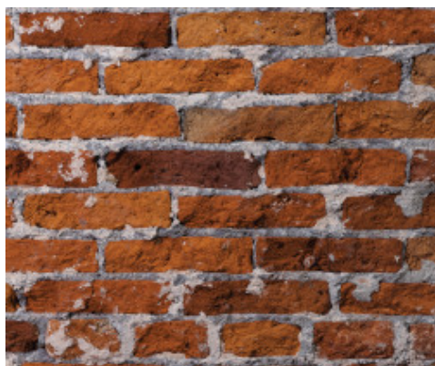
Perete de caramida dupa indepartarea tencuielii deteriorate
